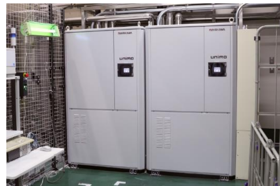
生産設備に採用した「ユニモWW」×2台
