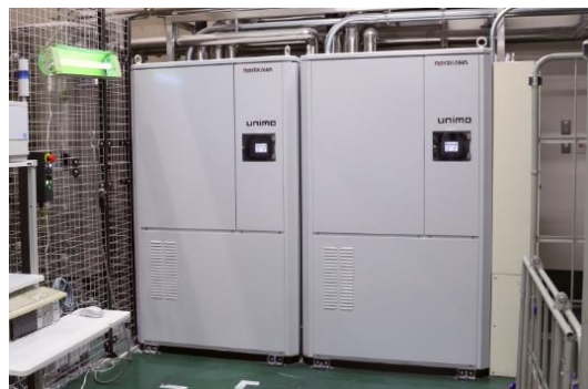
生産設備に採用した「ユニモWW」×2台
