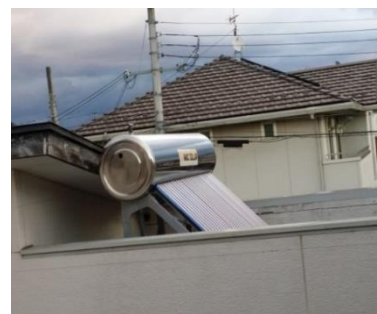
ご主人が購入し組み立てて設置した手作り「太陽熱温水器」
